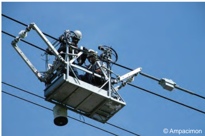
Capteur ADR-Sense, ELIA Doel (installation)
